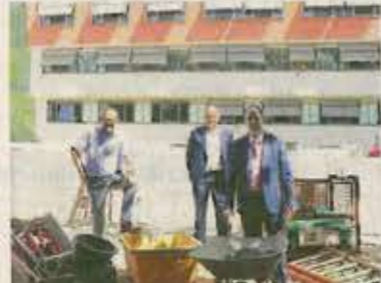
Stellvertretender Landrat Franz Clemens Brechtel, Marc Engelhard und Christian Pröll (von links) besichtigen die Baustelle.
